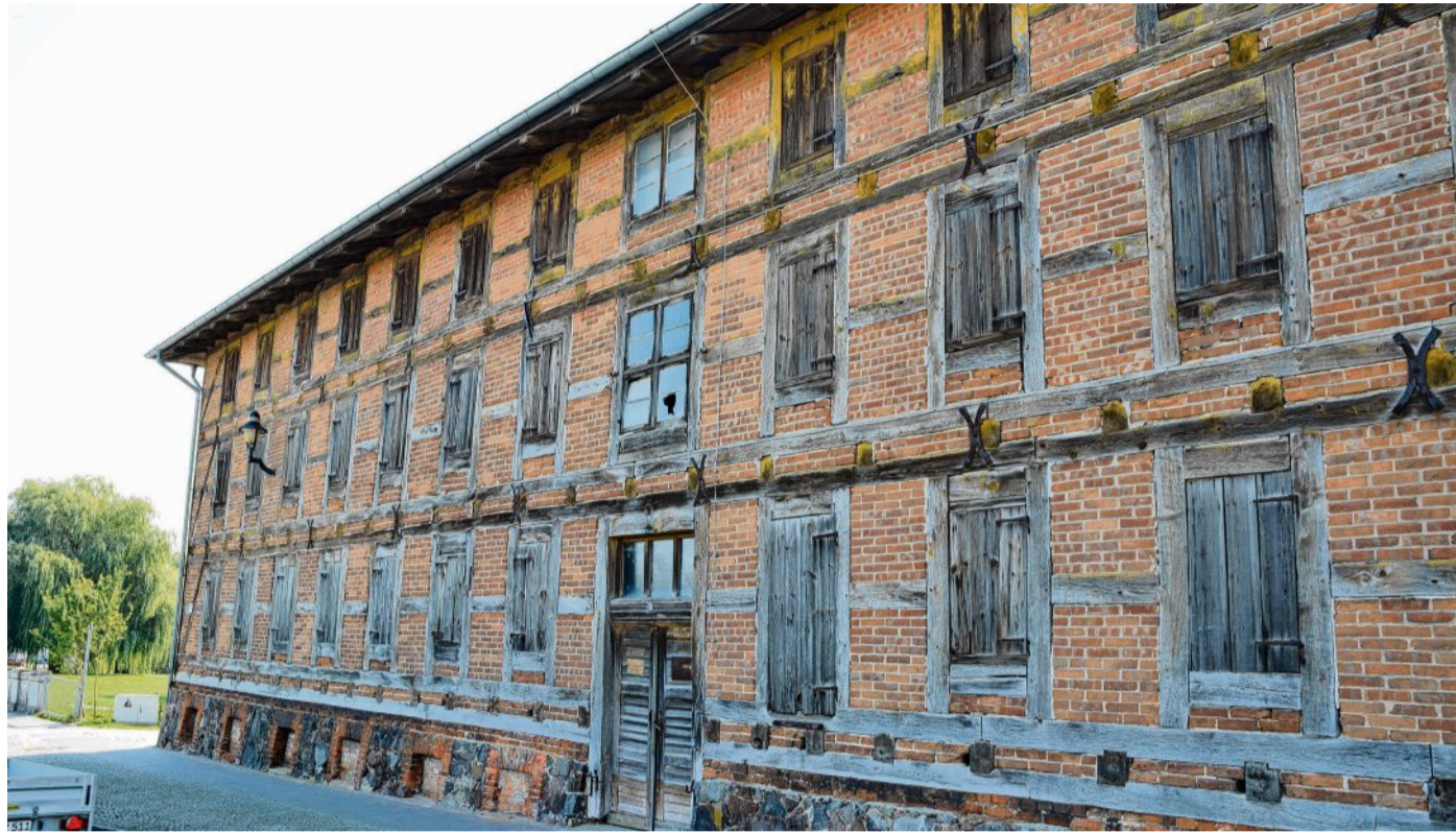
Der alte Speicher gilt als klarer Favorit bei der Standortwahl für die geplante Ausstellung. Doch vorher muss das Gebäude grundlegend saniert werden. FOTO: TOBIAS HOLTZ
